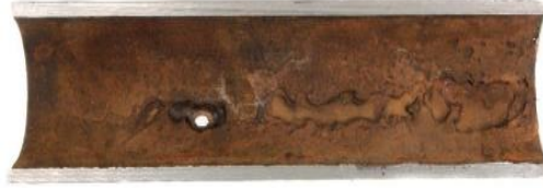
Şəkil 2. 180 sutka istismardan sonra \varnothing 73 \times 5,5 mm borunun metalının korroziya dağılması
