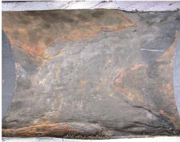
Şəkil 3. 1316 sutka istismardan sonra \varnothing 219 \times 18 mm borunun metalının korroziya dağılması
