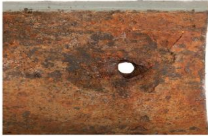
Şəkil 5. 66 sutka istismardan sonra Ø 73x5,5 mm borunun metalının korroziya dağılması
